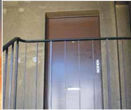
Blick in das verrußte Treppenhaus
