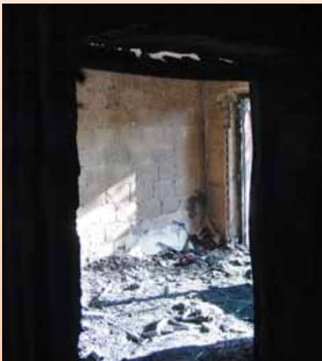
Blick in die Brandwohnung
